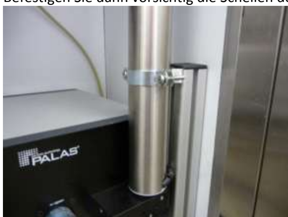
Abbildung 19: Interne Fixierung des Probenahmerohres
