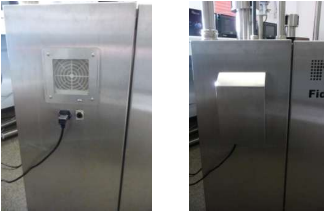
Abbildung 23 A+B: Netzanschluss des Wetterschutzgehäuses
